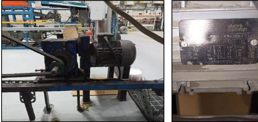
Şekil 52 Fırın 3 Hat Elektrik Motoru
