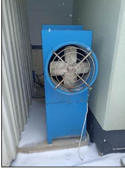
Şekil 39 Soğutma Kulesi 6 (Devrede Değil)
